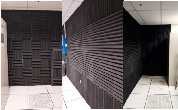
Gambar 3.5.2 Panel Akustik di bilik server, FPTV
